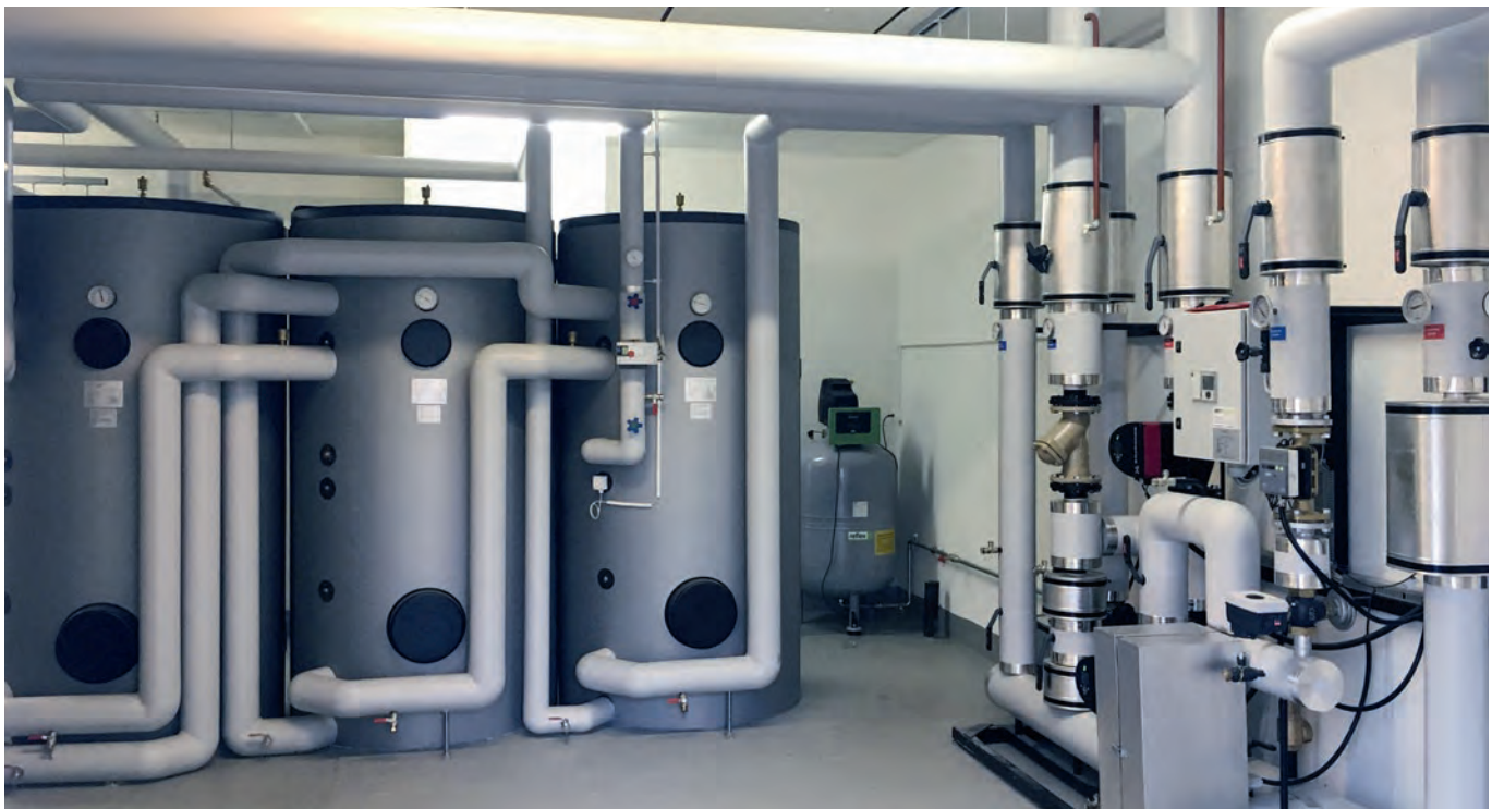
Anschluss Überbauung Geelig 1–12 («Wagenburg») Hauptübergabestation inkl. Warmwasseraufbereitung 3 × 1200 Liter Speicher
