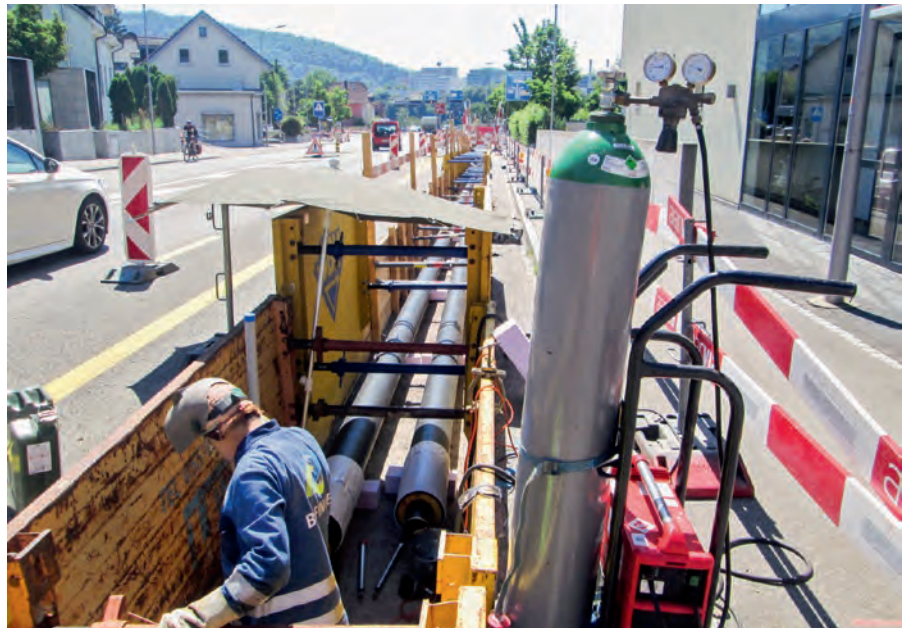
Auch die Leitungsverlegung auf der stark befahrenen Landstrasse hielt die ganze Mannschaft auf Trab.
