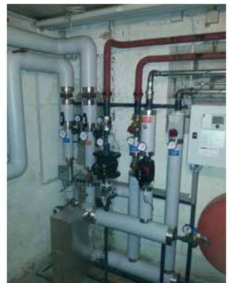
• Fernwärme-Station an gleicher Stelle nach dem Umbau
