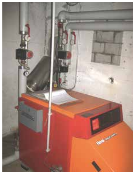
• Sanierungsbedürftige Ölheizung vor dem Umbau
